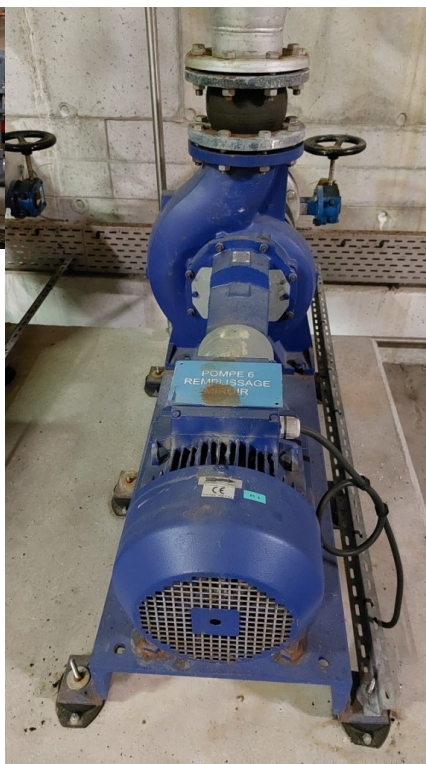
Pompe de remplissage du miroir d'eau. © J.-C. Mialocq
