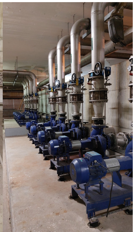
Batterie des pompes de remplissage. © J.-C. Mialocq
