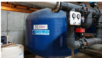
Filtre à sable pour le traitement et le conditionnement des eaux. © J.-C. Mialocq
